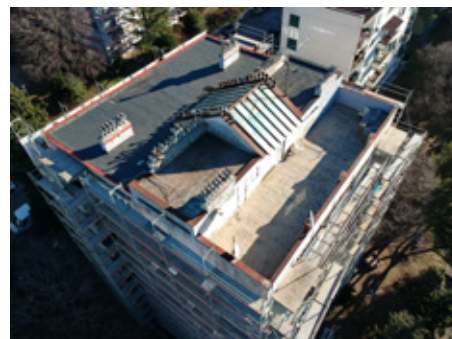
Slika 21: Drage Gervaisa 24, Rijeka – krov prije rekonstrukcije (izvor: Fond za zaštitu okoliša i energetska učinkovitost)
